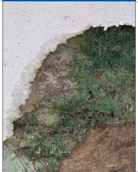
Abb 3: Algenbefall unter der Dämmung aus Styropor
