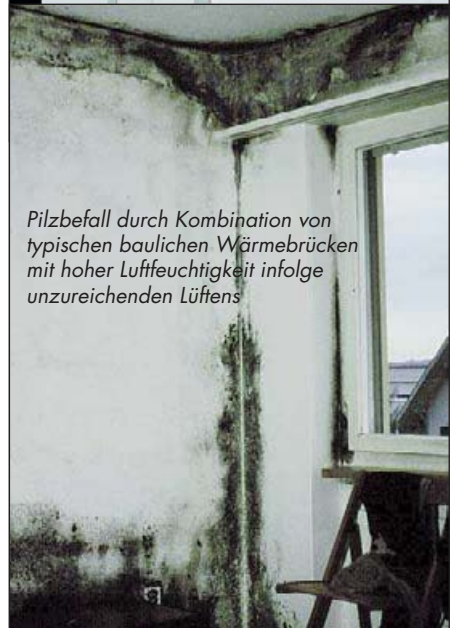
Pilzbefall durch eine Wärmebrücke
