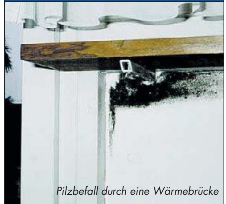
Abb 6: Pilzbefall durch Feuchtigkeitsanreicherung an der Oberfläche und im Bauteil
